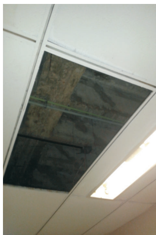
Ambulatório do 6º andar - Falta de placa no teto
