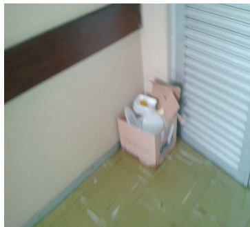
Enfermaria do 8º andar - Lixo colocado em local inadequado, próximo à copa
