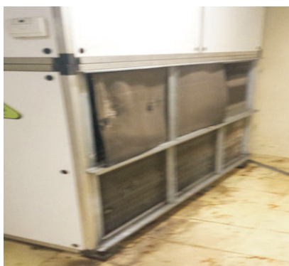
Sistema de Ar condicionado da urgência
