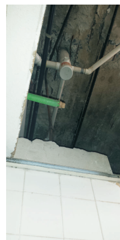
Enfermaria de Psiquiatria - 7º Andar - Teto do banheiro
