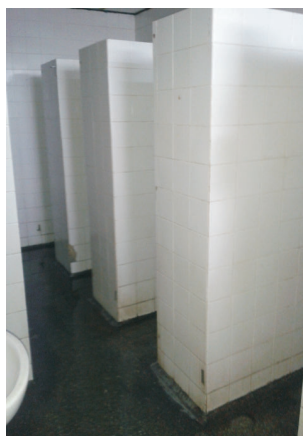
Ambulatório do 4º andar - Banheiro feminino todos sem portas
