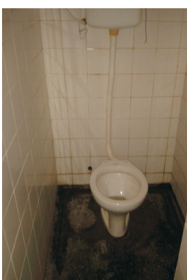
Sanitário feminino 3º andar sem porta e tampado vaso sanitário
