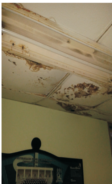
Térreo - Mofo no teto do corredor que dá acesso à Portaria 1
