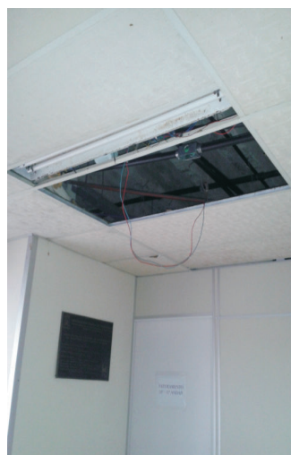
Enfermaria do 11º andar - Fiação exposta no hall
