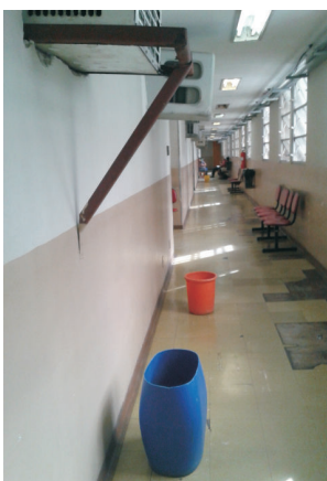
Ambulatório do 4º andar - Baldes para apagar a água que cai dos aparelhos de ar condicionados e piso desgastado
