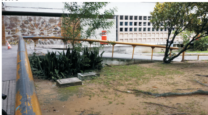
Área externa - Entrada da Portaria 1 do HC interdita por risco de vida pela queda de cimento e armação de ferro
