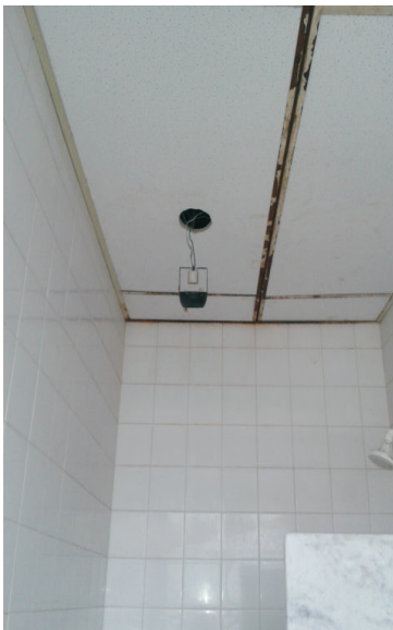
Enfermaria do 8º Norte - Banheiro da enfermaria sem lâmpada
