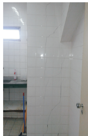
Enfermaria do 11º andar sul - Rachaduras na sala do expurgo
