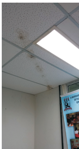
Térreo - Chefia do SS - vazamento anuncia futuro buraco no teto
