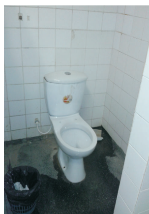
Ambulatório do 5º andar - Banheiro feminino sem porta, sem tampa no vaso e sem limpeza
