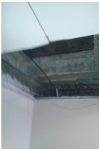
Ambulatório do 6º andar - Buraco no teto
