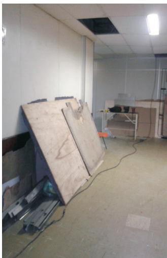
Enfermaria do 11º andar - Entulho em frente aos elevadores dos visitantes
