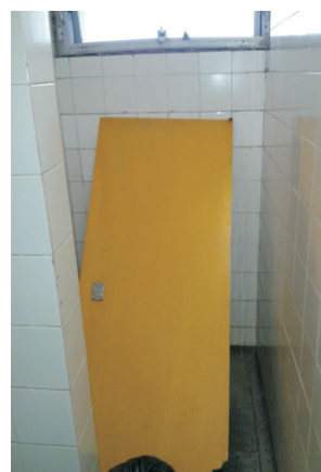
Ambulatório do 5º andar - Porta quebrada no banheiro feminino
