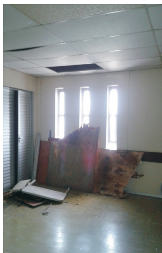
Enfermaria do 11º andar - Entulhos perto da copa
